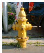
図 3.8 函館の消火栓 出典 [1]
